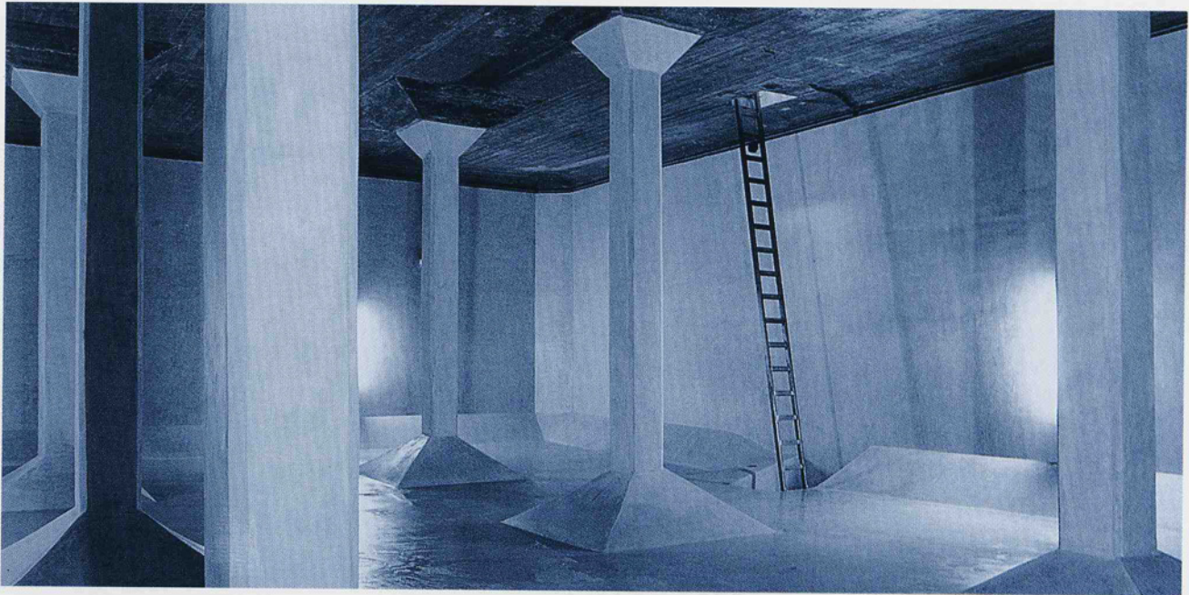
Wasserkammer des Reservoirs
